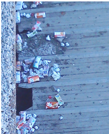
Muestra de la basura tirada sobre el tejado de las gradas del campo de fútbol.
